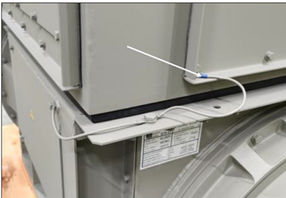
FIGURA 11. CAVO DI MESSA A TERRA
