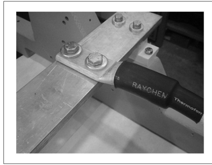
FIGURE 23. BRIDE DE CÂBLE CORRECTE
